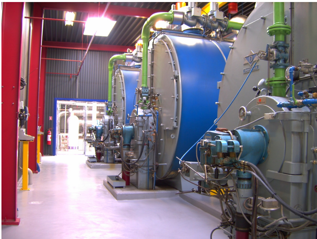
Kedelanlægget i Brøndbyøster
