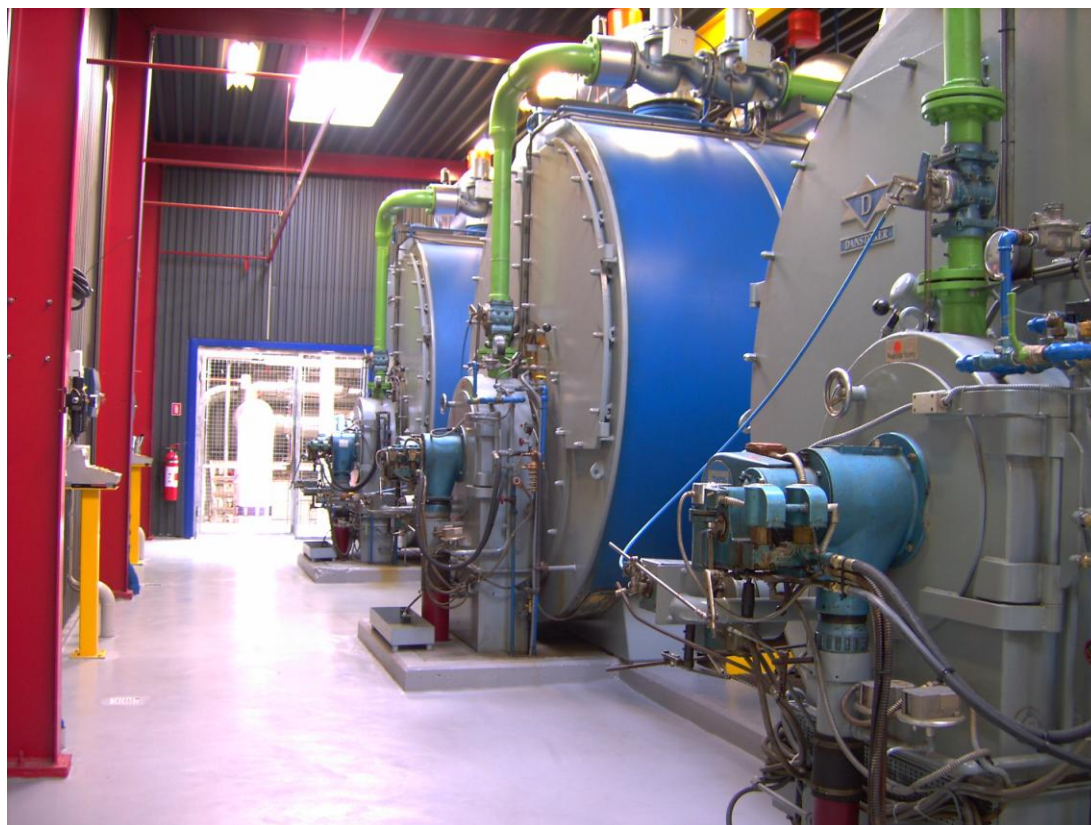
Kedelanlægget i Brøndbyøster
