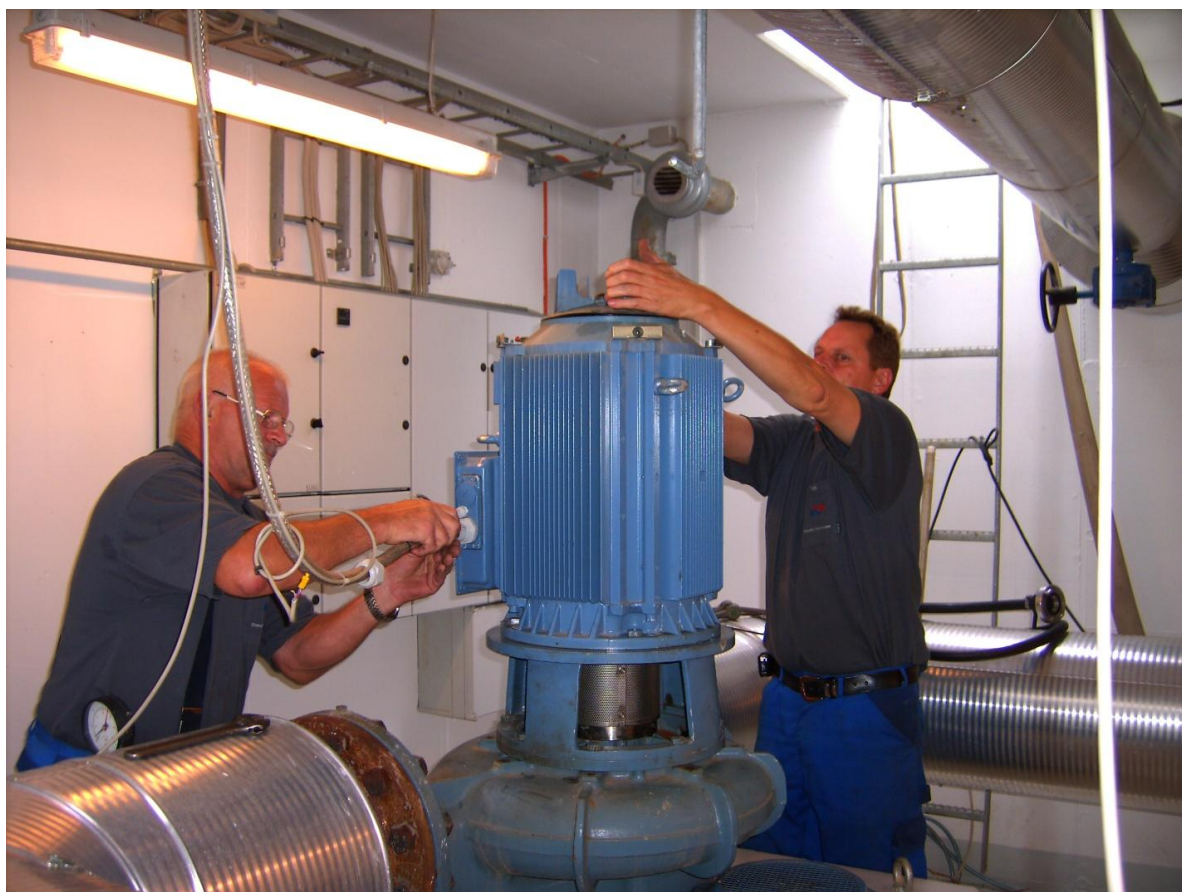
Boosterstation ved Park Allé
