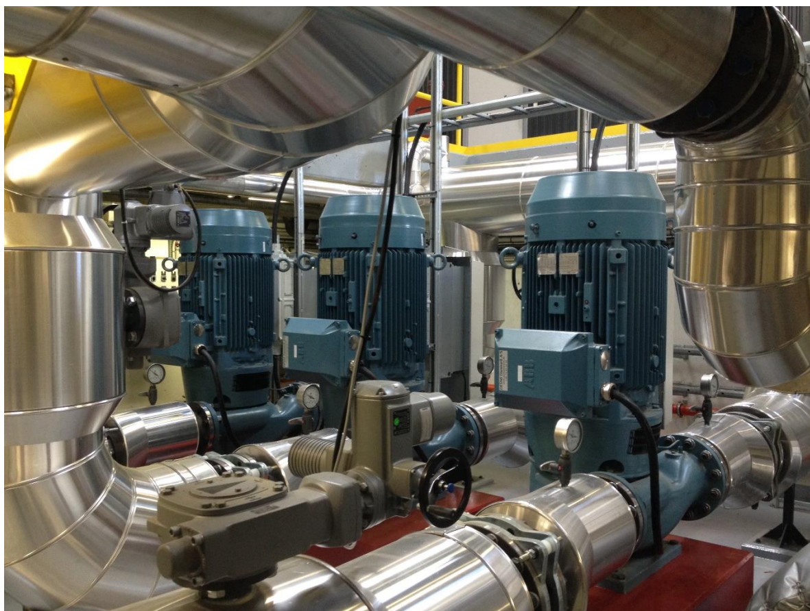
Nye distributionspumper på Østercentralen
